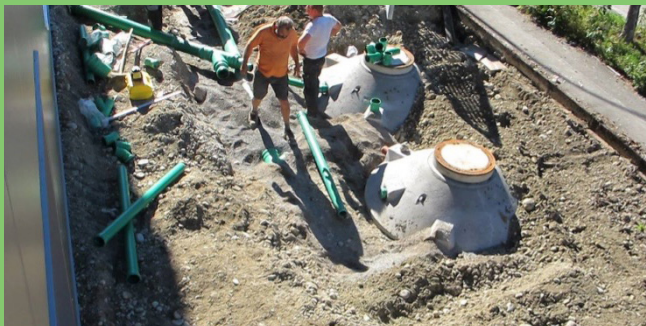
9,4 m 3 Regenwasser Retentionszisternen zur Regenwasserspeicherung
