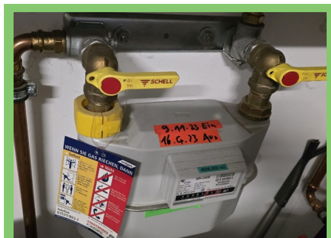
Gasbrennwerttherme betrieben mit Biogas nur für Wintermonate
