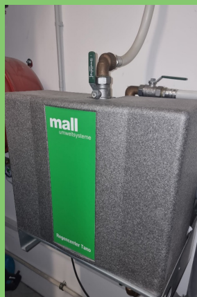
Regenwasseraufbereitung für Toiletten und sonstiges Brauchwasser
