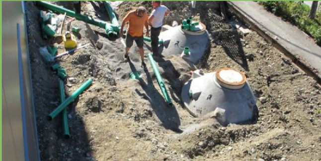
9,4 m 3 Regenwasser Retentionszisternen zur Regenwasserspeicherung
