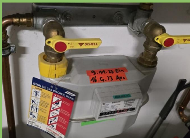
Gasbrennwerttherme betrieben mit Biogas nur für Wintermonate
