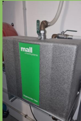
Regenwasseraufbereitung für Toiletten und sonstiges Brauchwasser
