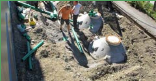
9,4 m 3 Regenwasser Retentionszisternen zur Regenwasserspeicherung
