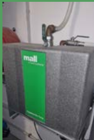
Regenwasseraufbereitung für Toiletten und sonstiges Brauchwasser
