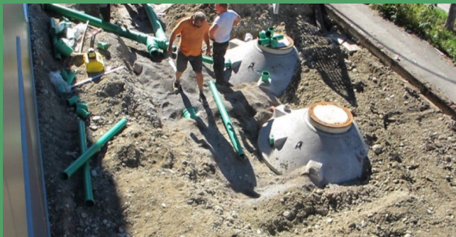
9,4 m 3 Regenwasser Retentionszisternen zur Regenwasserspeicherung
