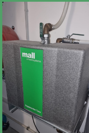
Regenwasseraufbereitung für Toiletten und sonstiges Brauchwasser
